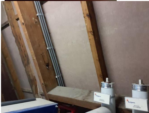
FB02: Het dakbeschot is conform de oude rapportage niet asbesthoudend.
