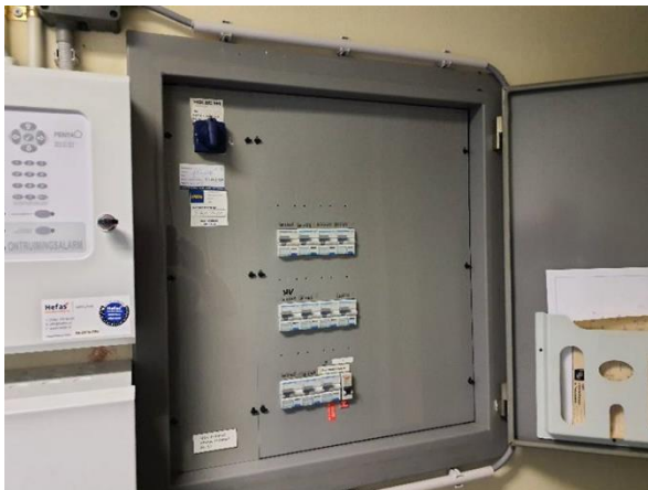
FB11: De LS- schakelaar is niet asbestverdacht.
