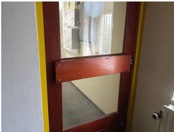
FB08: Ter plaatse van de binnendeuren met enkel glas kan asbestverdachte kit aanwezig zijn. Dit kan alleen met destructief onderzoek worden bepaald.
