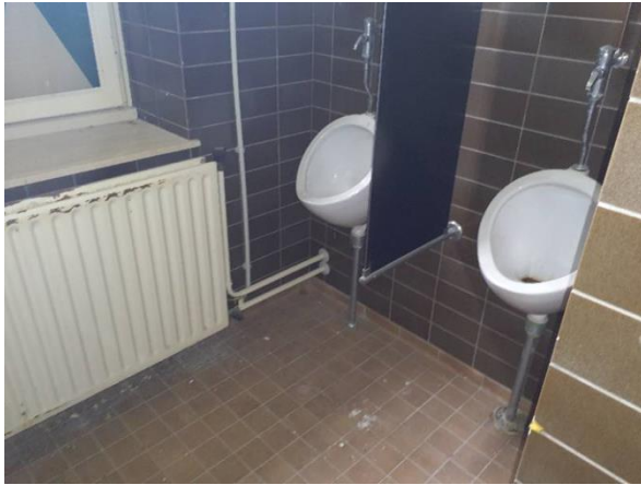
FB04: Achter het tegelwerk is geen inspectie mogelijk.
