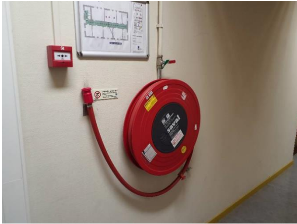
FB04: De brandslanghaspel is niet asbestverdacht.
