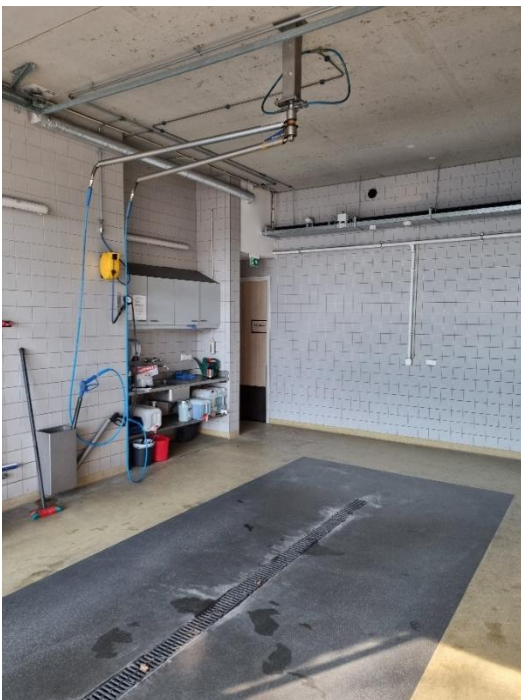
figuur 3 | Voorbeeld van een wasinstallatie te Ulvenhout.
