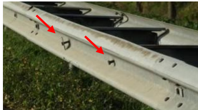
A fbeelding 12 Bevestigingsmiddelen niet correct aangehaald
