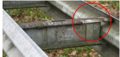
A fbeelding 11 Ernstige roestvorming veroorzaakt gaten in de afstandhouder
