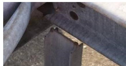
Afbeelding 29 Montagelip is volledig afgescheurd
