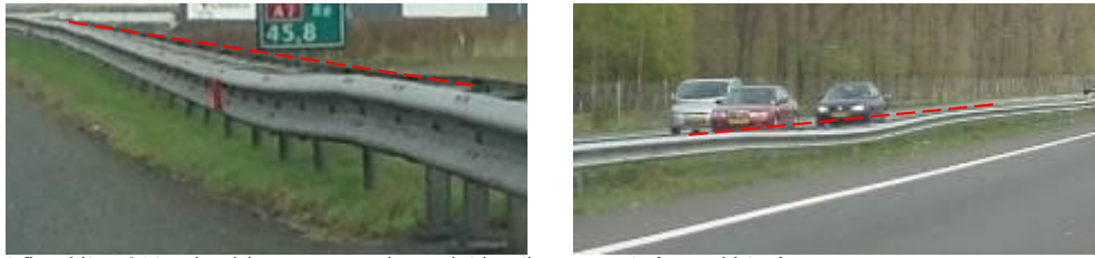
Afbeelding 6 Voorbeelden van verzakte geleiderailconstructie (verzakking)
