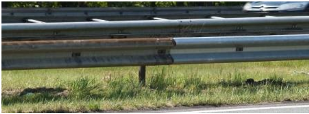
Afbeelding 14 Geleiderailplank aangetast door corrosie.
