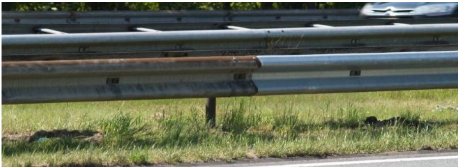
Afbeelding 35 Roestvorming aan de geleiderailconstructie
