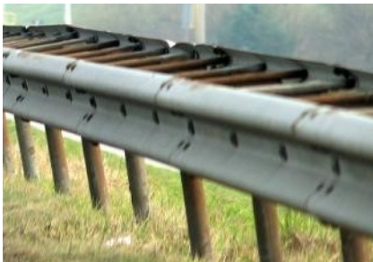
Afbeelding 34 Geleiderail en roestvorming
