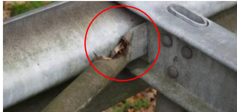
A fbeelding 10 Beschadigingen aan de diagonaal door roestvorming
