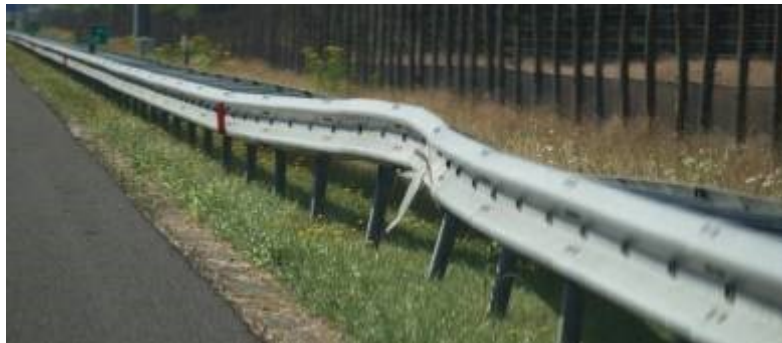
Afbeelding 1 Schade door een aanrijding.
