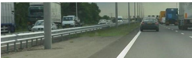
Afbeelding 16 Lichtmasten geplaatst in de middenberm zonder afscherming
