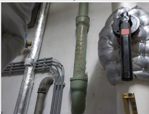
Gietijzeren riolering: mogelijk is asbestkoord in de moffen gebruikt (niet bereikbaar zonder sloep)
