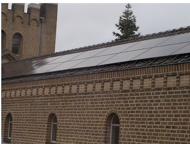
Het kanaal komt niet boven de dakpannen uit
