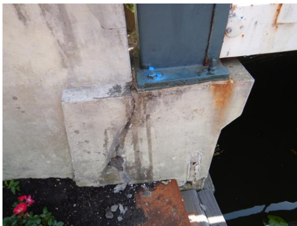
Figuur 2.17: Scheurvorming in afsmeerlaag en beton
