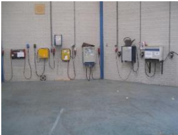
Impressie van de accu oplaadplaats in gebouw 2
