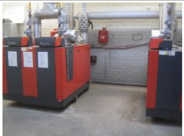
Centrale verwarmingsketels in gebouw 1 op de verdieping.
