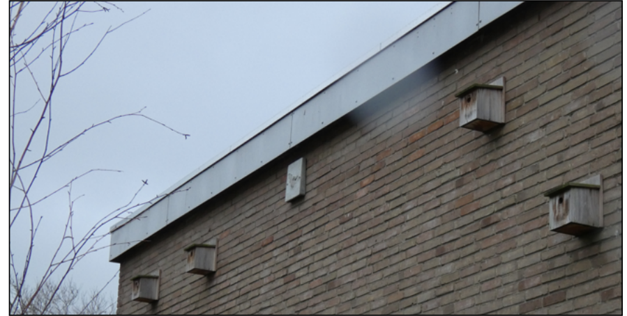
Figuur: bebouwing met voorzieningen. Op verschillende gebouwen in het plangebied zijn reeds voorzieningen aangebracht, zoals huismuskasten en vleermuiskasten.
