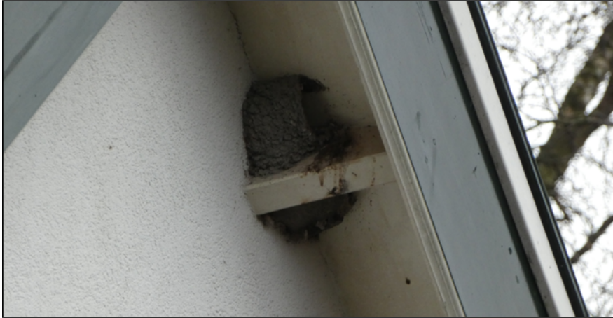
Figuur: bebouwing met verblijfssporen. Aangetroffen nesten van huiswaluw onder de gevelbetimmering van bebouwing aan de Bermweg
