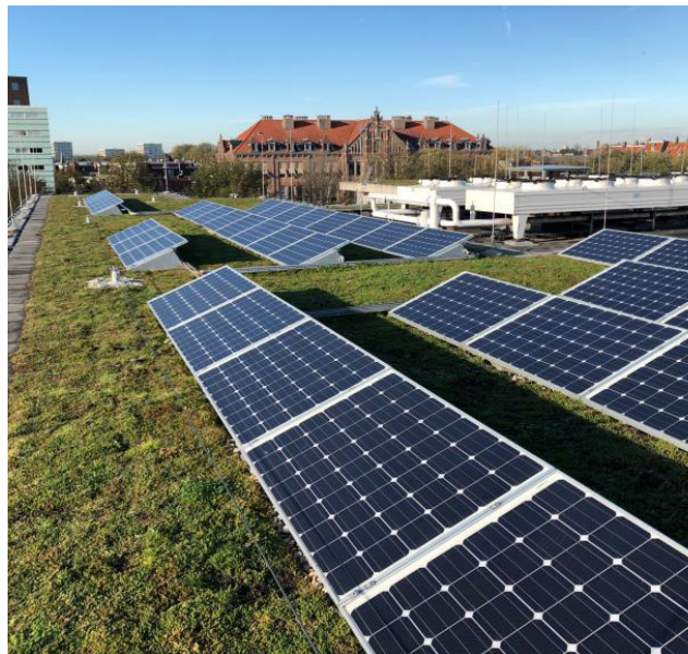
Groendak met geïntegreerde zonnepanelen/installaties
