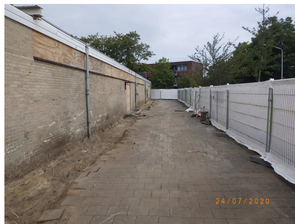
Nr 9: Chroom 6 houdende verf restanten verwijderd direct aangrenzend terrein (fase 3)
