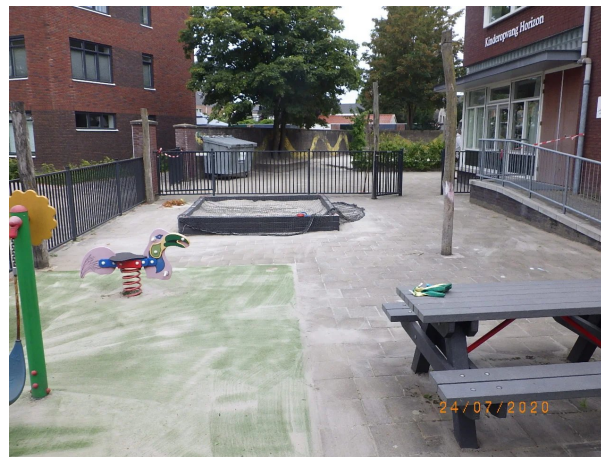
Nr 14: Chroom 6 houdende verf restanten verwijderd speeltuin kinderopvang (fase 4)
