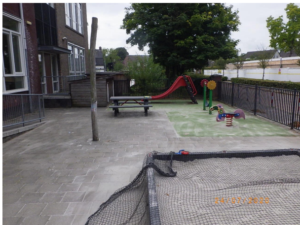
Nr 13: Chroom 6 houdende verf restanten verwijderd speeltuin kinderopvang (fase 4)
