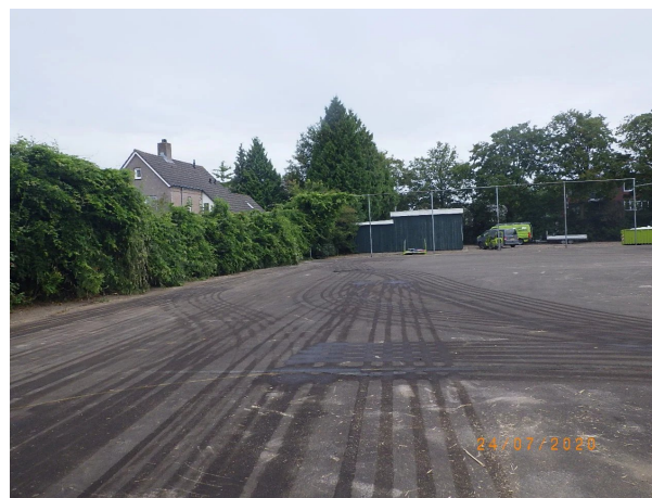
Nr 3: Chroom 6 houdende verf restanten verwijderd sportveld (fase 1)
