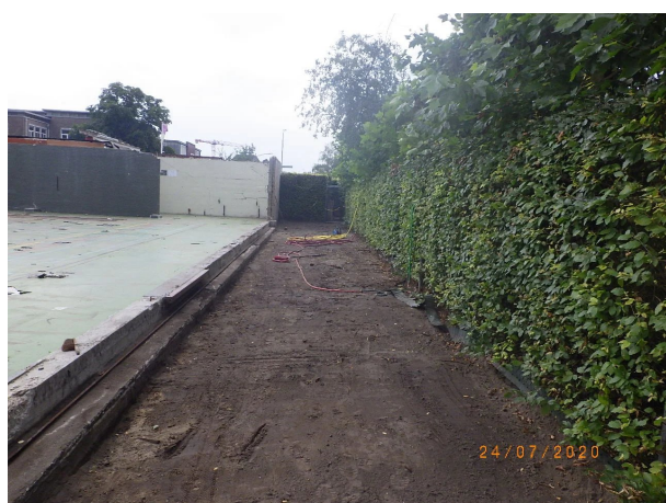
Nr 10: Chroom 6 houdende verf restanten verwijderd direct aangrenzend terrein (fase 3)
