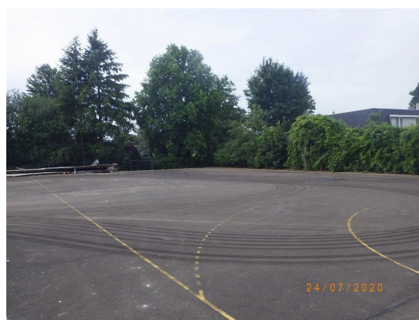
Nr 4: Chroom 6 houdende verf restanten verwijderd sportveld (fase 1)
