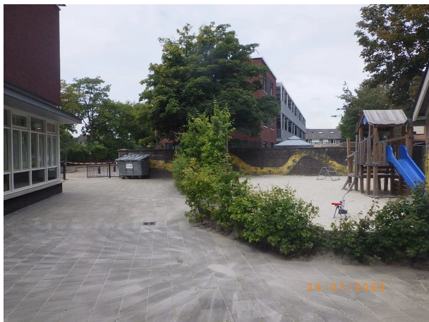
Nr 15: Chroom 6 houdende verf restanten verwijderd speeltuin kinderopvang (fase 4)
