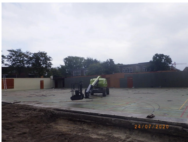
Nr 23: Lekdorpel, Hoekprofiel en damwandprofielen met chroom6 houdende verlaag verwijderd voormalig sporthal (fase 5)
