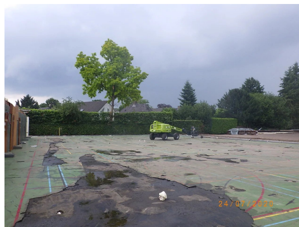
Nr 22: Lekdorpel, Hoekprofiel en damwandprofielen met chroom6 houdende verlaag verwijderd voormalig sporthal (fase 5)
