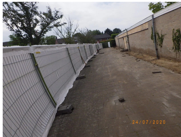
Nr 8: Chroom 6 houdende verf restanten verwijderd direct aangrenzend terrein (fase 3)
