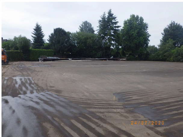
Nr 5: Chroom 6 houdende verf restanten verwijderd sportveld(fase 2)
