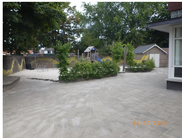
Nr 16: Chroom 6 houdende verf restanten verwijderd speeltuin kinderopvang (fase 4)
