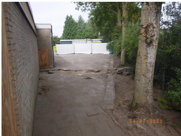
Nr 7: Chroom 6 houdende verf restanten verwijderd direct aangrenzend terrein (fase 3)
