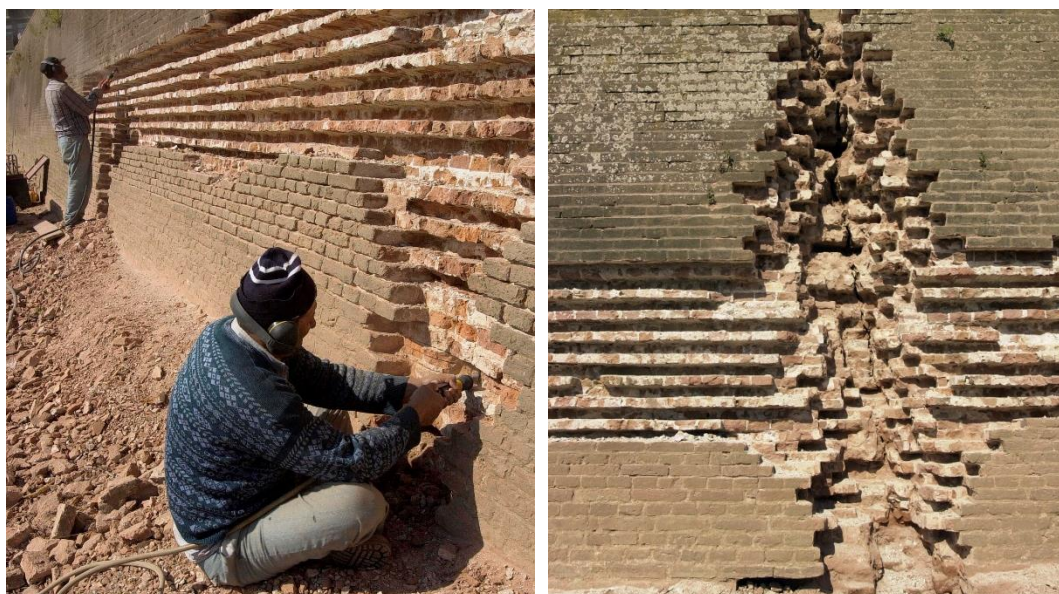
Afb. Twee voorbeelden van het uitnemen van bestaand metselwerk voor inboetingen over meerdere lagen, de koppen en strekken lagen van de inboeting wisselen steens en halfsteens met elkaar af om te voorkomen dat er een halfsteens klamplaag ontstaat.
