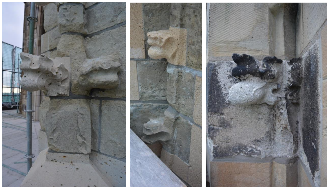
Afb. Drie voorbeelden van (deel)vervangingen van architecturaal beeldhouwwerk waarbij slechts enkele blokjes ingeschoten dienen te worden. De vormgeving wordt gebaseerd op nog goed afleesbare modellen aan het monument.
