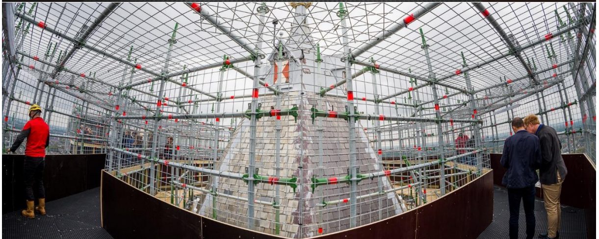
Afb. Twee afbeeldingen van de bezoekerstoegankelijke steigerkooi van de Domtoren, gedurende de uitvoering kon het publiek op een veilige manier van de toren(klim) gebruik maken. De kooi was afgesloten van de bouwsteiger waardoor deze veilig gebruikt kon worden. Naast de bezoekerstoegankelijke kooi is in Utrecht een tweede lift geplaatst om ook mindervalide bezoekers, die doorgaans de toren niet kunnen beklimmen, de kans te geven om van het uitzicht te genieten.
