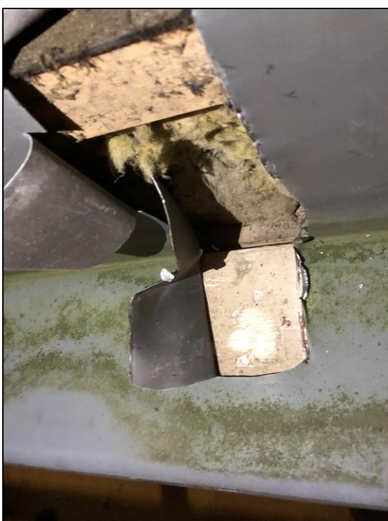
Afbeelding 12 – waterkerende laag onder het zink niet doorgezet
