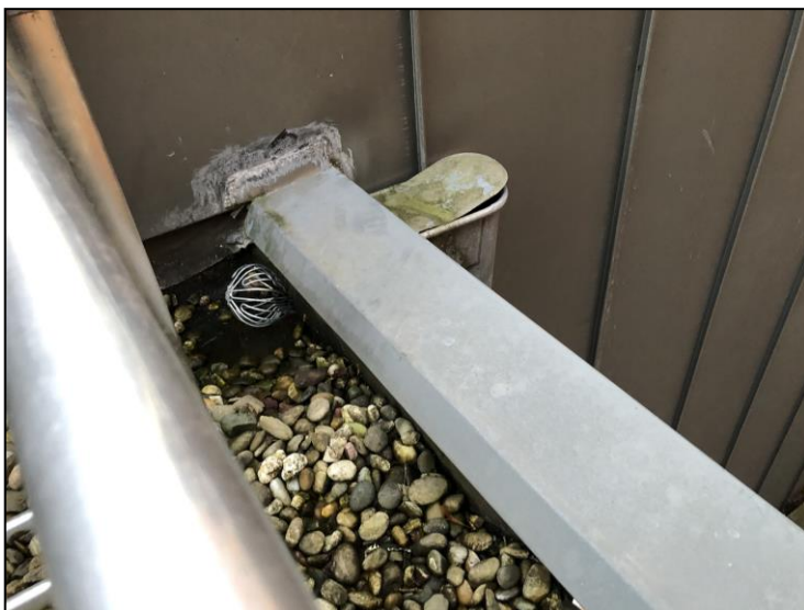
Afbeelding 13 – dakrand detail van dakvlak A3 is in 2008 niet gewijzigd
