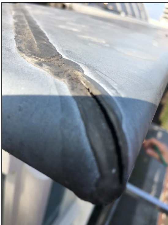
Afbeelding 9a – gescheurde lasnaden op de hoeken van het dakzink van de dakkapel
