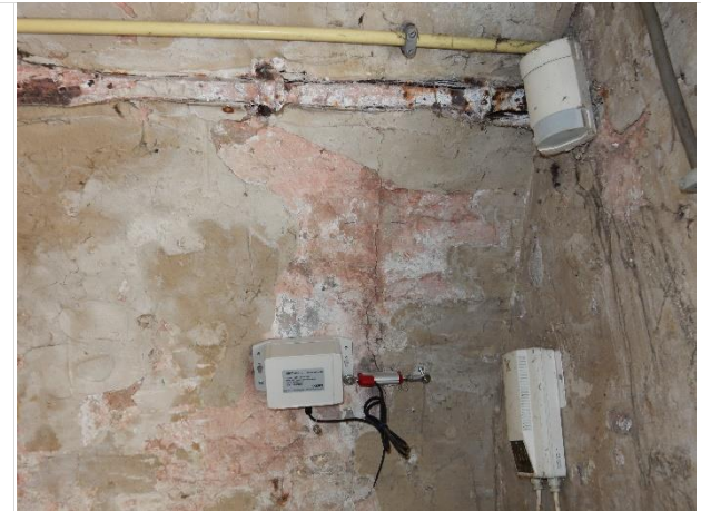
Scheur rechterzijde, monitoring van de scheur Schade coor anker
