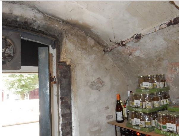
Schade aan pleisterwerk, schade door muuranker
