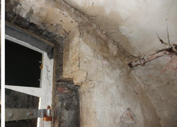
Verwijdering van kalf zorgt voor schade aan metselwerk
