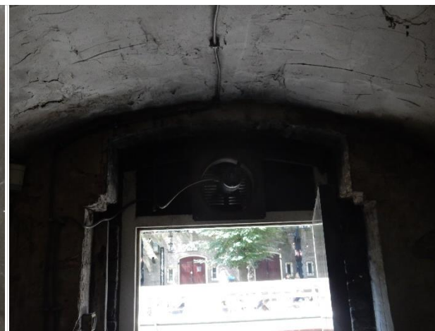
Ventilator boven deur
