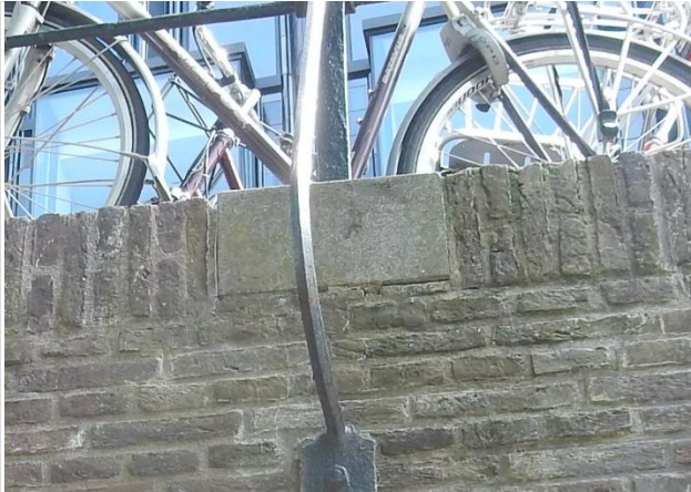
Plaatselijk wat uitgesleten voegwerk rollaag
