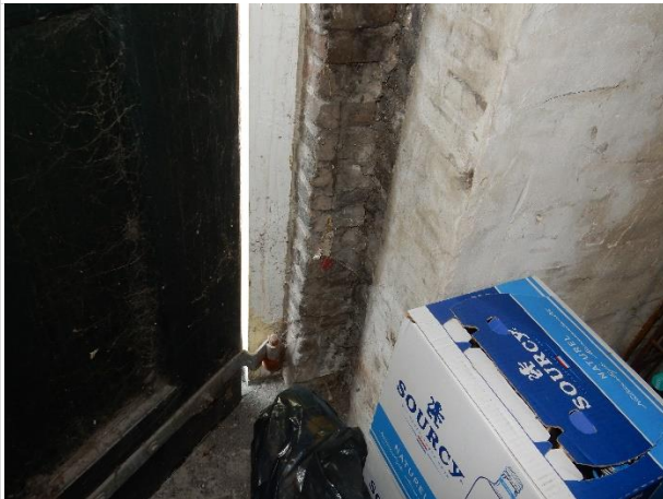
Corrosie duim, modern gegalvaniseerd geheng
