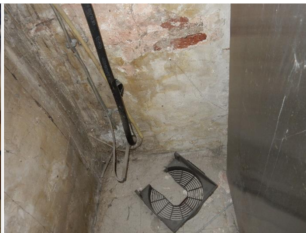
Waarschijnlijk de doorvoer van de electra
