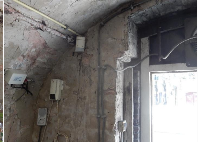
Schade aan pleisterwerk, schade door muuranker
