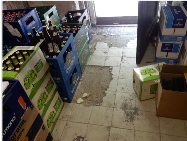
Schade tegelvloer en scheurvorming dekvloer
