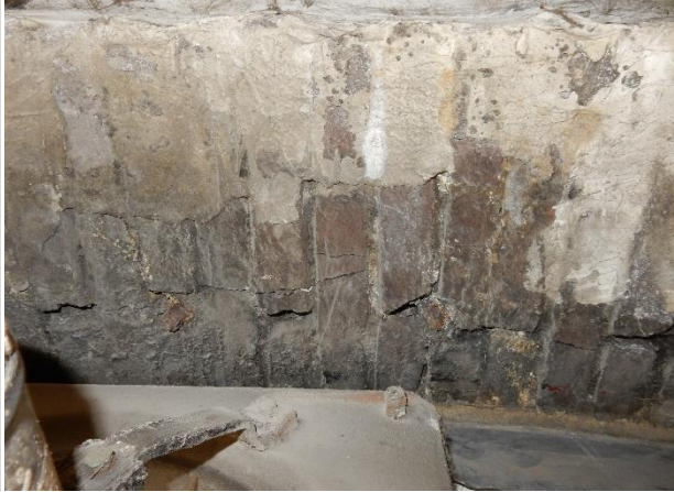
Schade metselwerk door corrosie oude tralies
