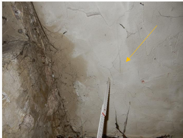
Scheurvorming toeg zorgt voor schade aan pleisterwerk
