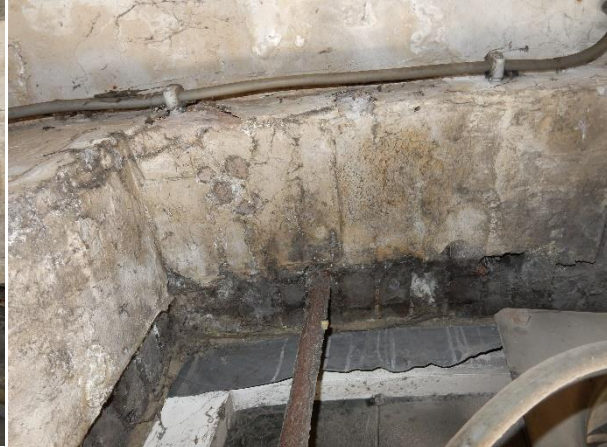
Schade metselwerk door corrosie oude tralies
