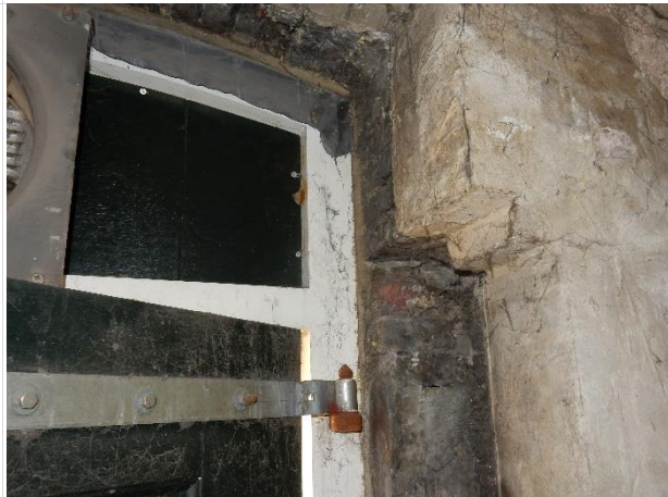
Corrosie duim, modern gegalvaniseerd geheng
