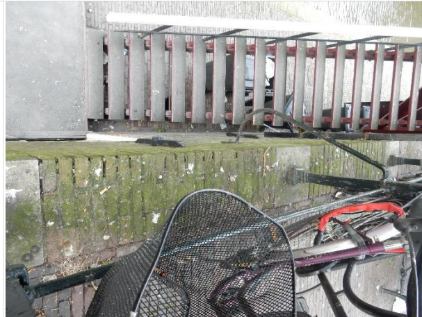
Uitgevallen voegwerk rollaag
