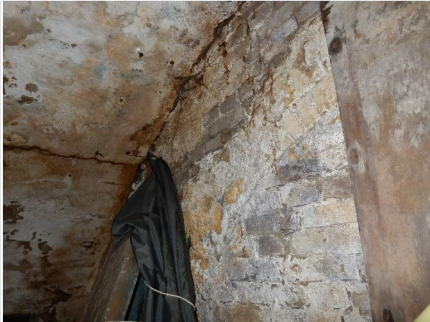
Scheurvorming haaks op de toog linkzijdig, opening tussen gewelf en muur
