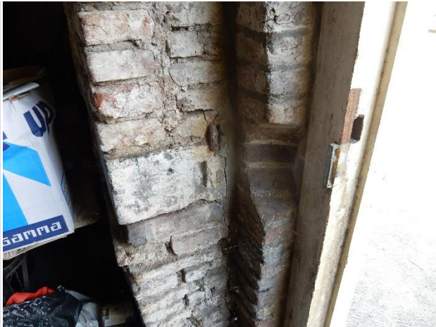
Schade aan metselwerk door corroderend ijzerwerk
