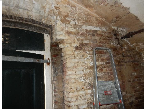
Metselwerk verzakt door aanpassen van de deuropening
