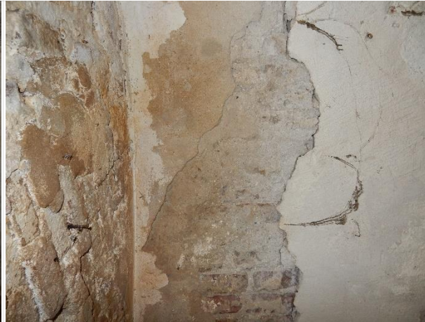
Eerste scheur linkzijdig
