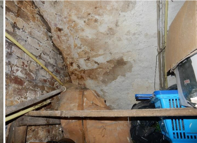
Scheurvorming haaks op de toog rechterzijdig, opening tussen gewelf en muur
