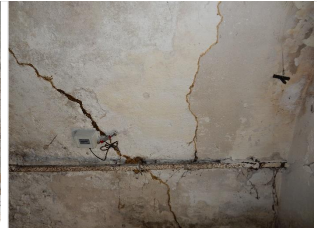
Scheur linkzijdig splitst, monitoring van de scheur
