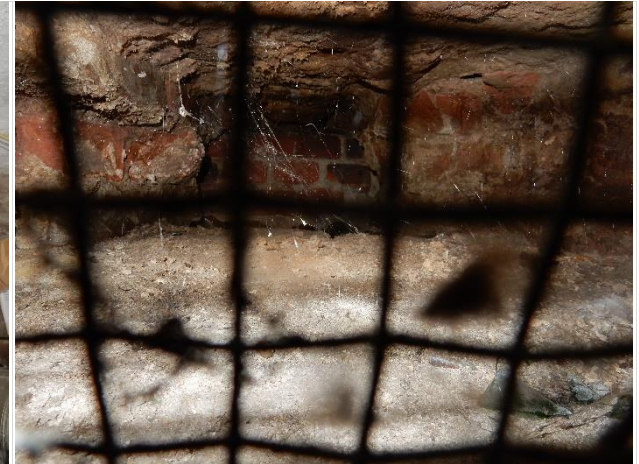
Gat in wand linkzijdig, muur naastliggende kelder zichtbaar (112-E)
