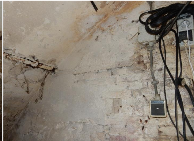
Scheur in metselwerk, corrosie anker, pleisterwerk verzand
