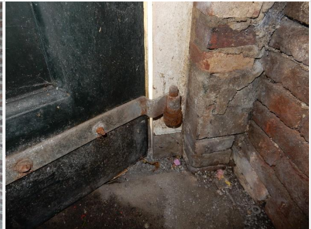
Corrosie duim en bevestigingen gehengen
