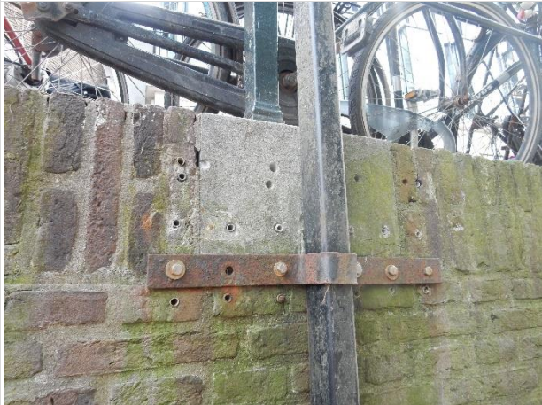
Schade metselwerk en natuursteen door oude bevestigingen
