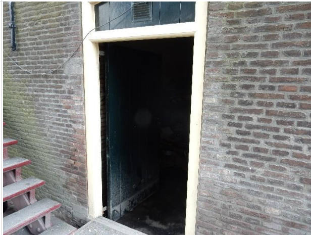
Deur en kozijn onder niveau grindbak
