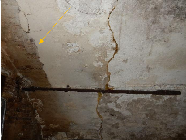
Scheurvorming (2x) rechterwand
