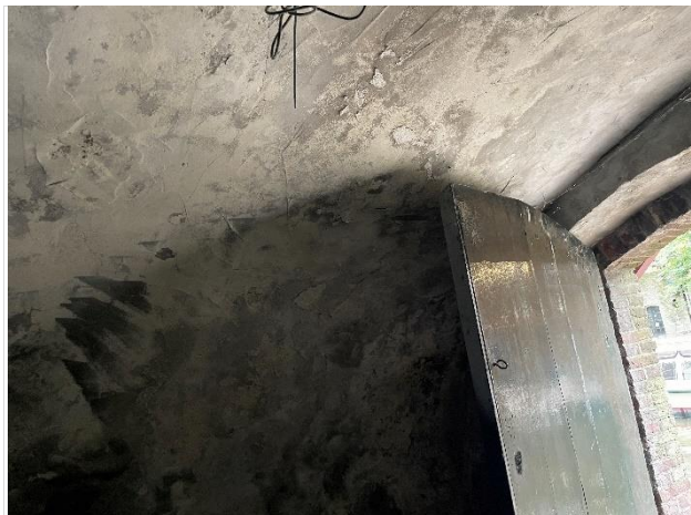
Scheurvorming in toog zichtbaar
