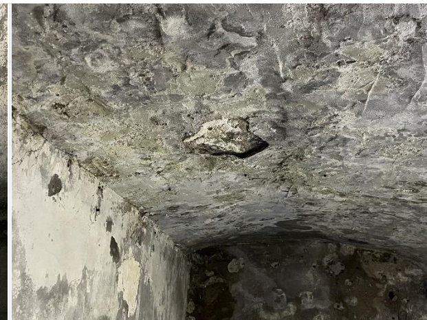
Pleisterwerk komt in schollen los
