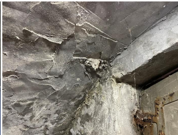
Rondom verankeringen pleisterwerk aangesmeerd
