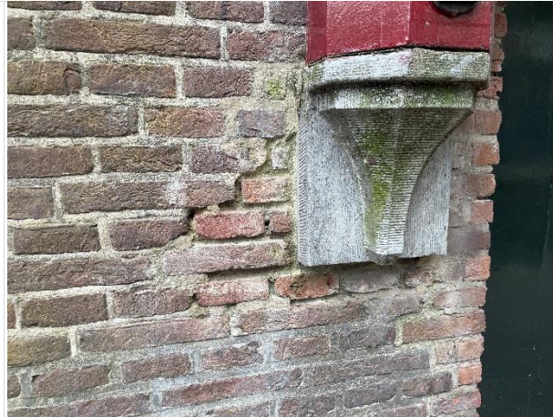
Voegwerk is uitgesleten
