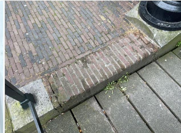
Plaatselijk is wat voegwerk van de rollaag gesleten
