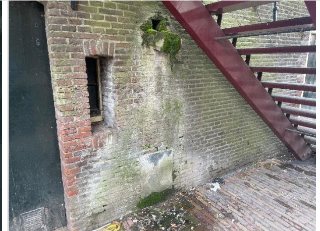
De spuwer aan de rechterzijde, forse vocht- en zoutbelasting
