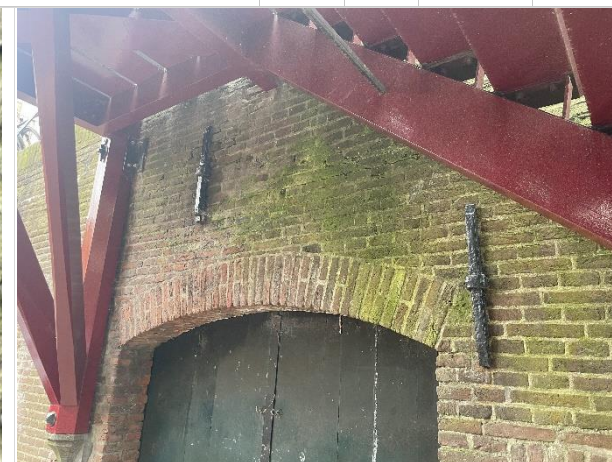
Er zijn twee muurankers aanwezig, deze roesten op
