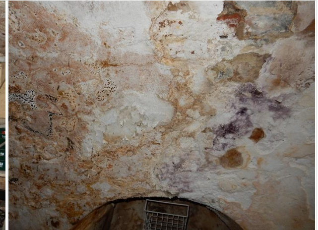
Vochtschade aan pleisterwerk
