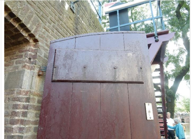
Binnenschilderwerk deuren vervuild.
