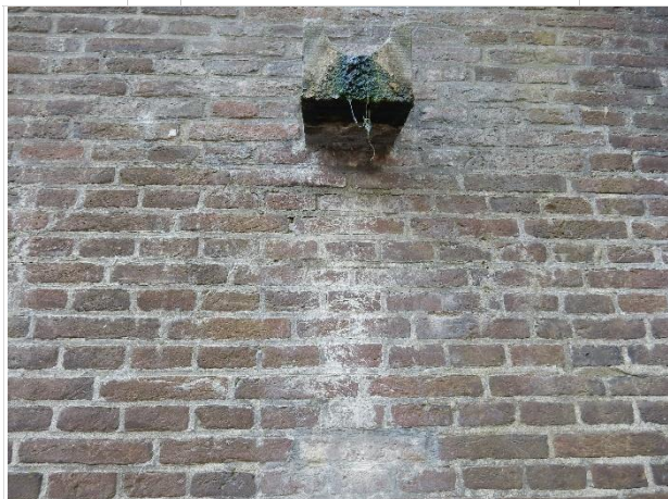
Schade door vochtaantasting
