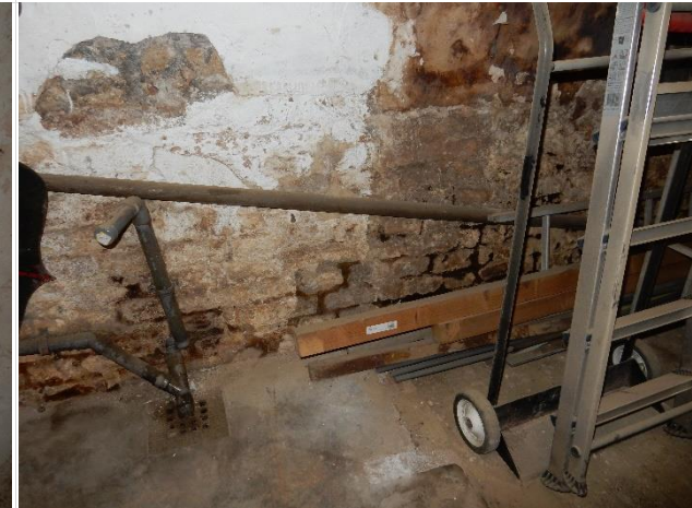
Mos en schimmel metselwerk
