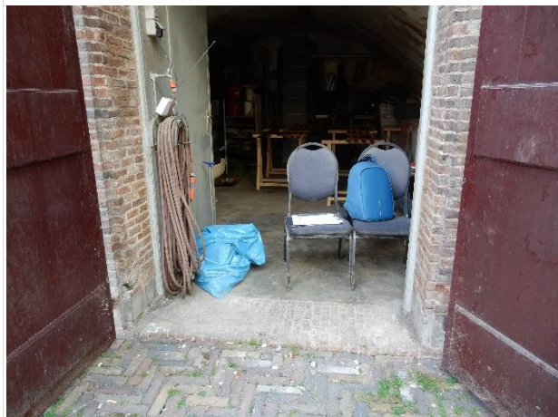
Schade aan bakstenen door uitfrezen sponning
