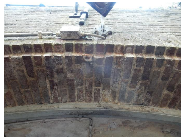
Schade door vochtbelasting aan bakstenen en voegwerk
