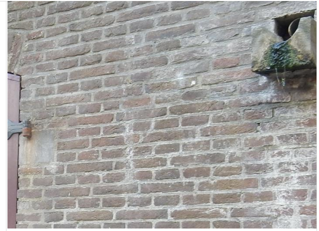
Locatie zichtbaar waar muuranker gezeten heeft
