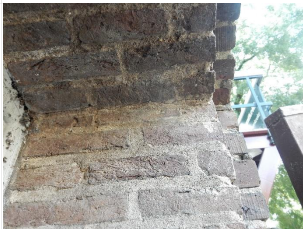
Scheur in rollaag
