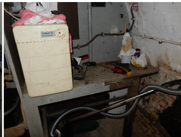
Boiler buiten werking
