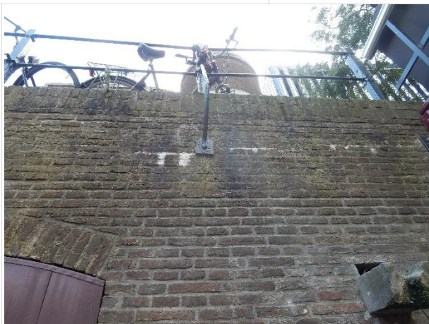
Schade door vochtaantasting
