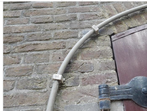
Voegwerk niet voldoende diep aangebracht
