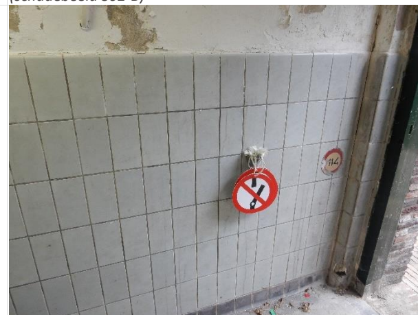
Tegelwerk klinkt hol, beschadigingen
