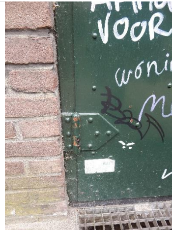
Ontbrekend schilderwerk en lichte corrosie scharnier
