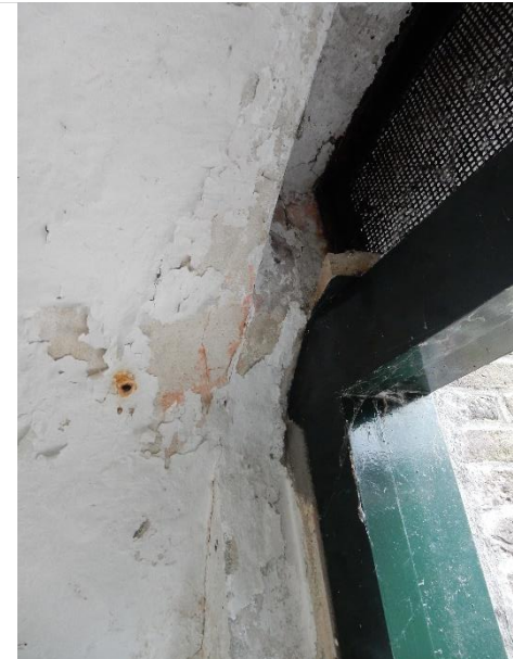
Werfmuur lijkt los te scheuren
