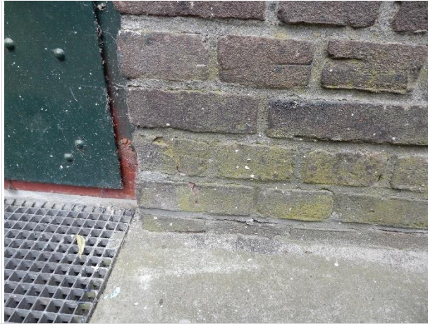
Schade aan baksteen en voegwerk sluit niet aan op baksteen
