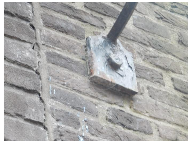
Befestigingen hekwerk corroderen
