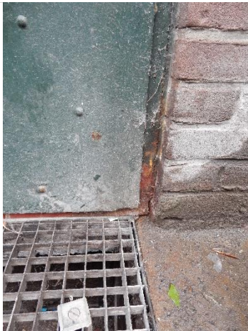
Corrosie onderzijde deurkozijn
