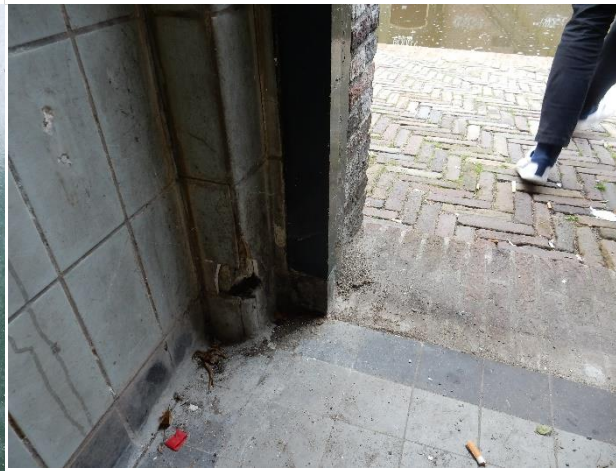
Tegelwerk (binnenzijde werfmuur) gescheurd en beschadigd
