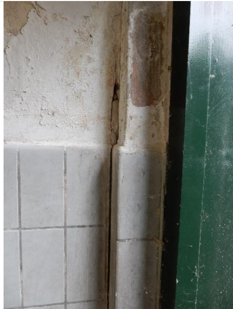
Werfmuur lijkt los te scheuren
