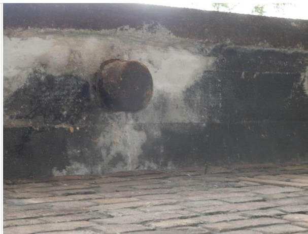
Schade hekwerk vanaf onderzijde
