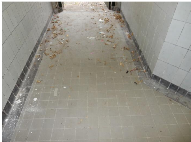
Slijtage en veroudering tegelwerk
