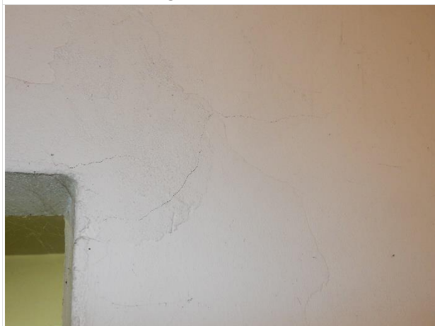
Scheurvorming ter plaatse van doorgang
