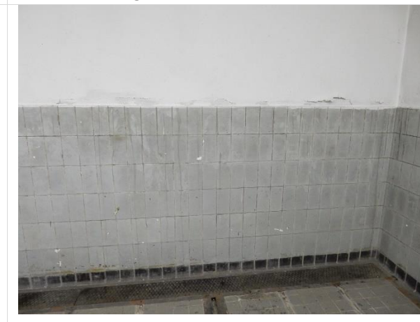
Tegelwerk klinkt hol, schade schilder- en pleisterwerk
