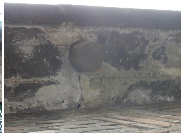
Grind betonnen afdekker is doorgescheurd t.p.v. hekwerk
