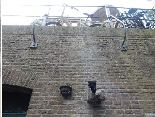
Aantasting spuwer door hemelwater, pvc buis tot buitenzijde metselwerk
