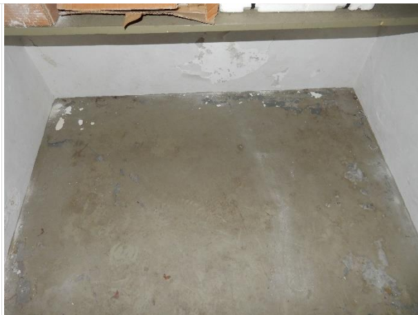
Slijtage en kale delen coating
