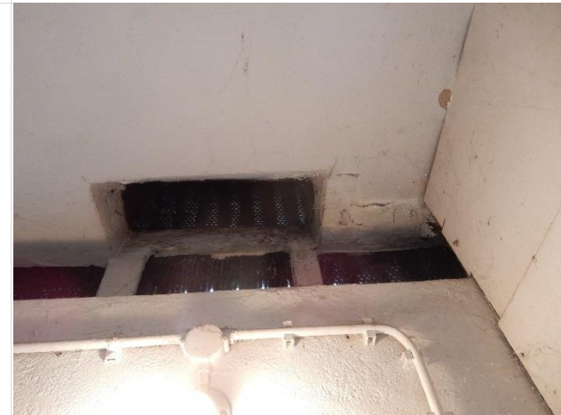
Roosters achter ventilatiesleuven zijn vervuild en vertonen corrosie.
