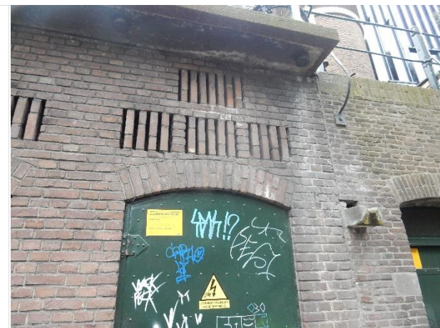
Vochtbelasting en zouten onder grind betonnen afdekker
