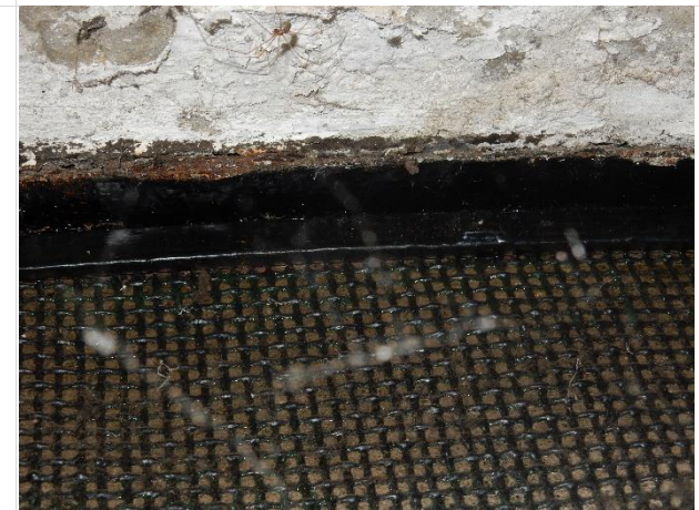
Corrosie rooster boven deur
