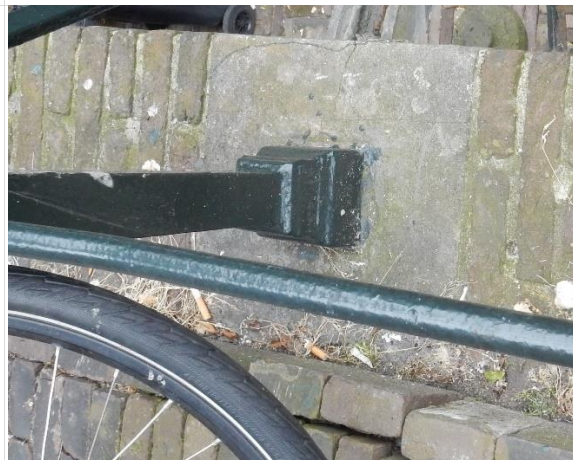
Natuursteen gescheurd door corrosie hekwerk
