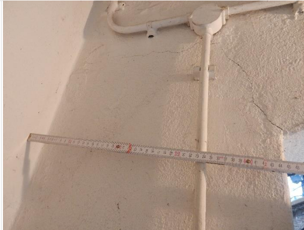
Scheur aan binnenzijde werfmuur t.p.v. deuropening
