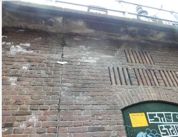
Scheurmeters laten werking zien, voegwerk t.p.v. dilatatie uitgevallen
