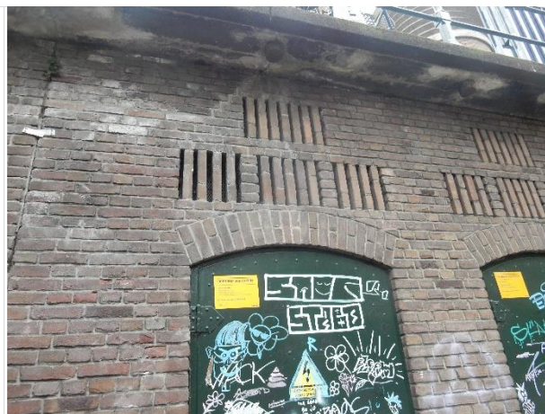
Vochtbelasting en zouten onder grind betonnen afdekker
