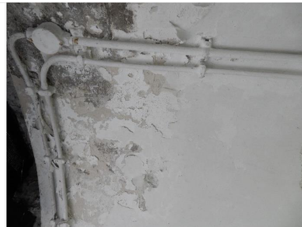
Schade in het pleisterwerk in de toeg ter plaatse van de werfmuur kan wijzen op scheurvorming in het metselwerk (schadebeeld S02-B)
