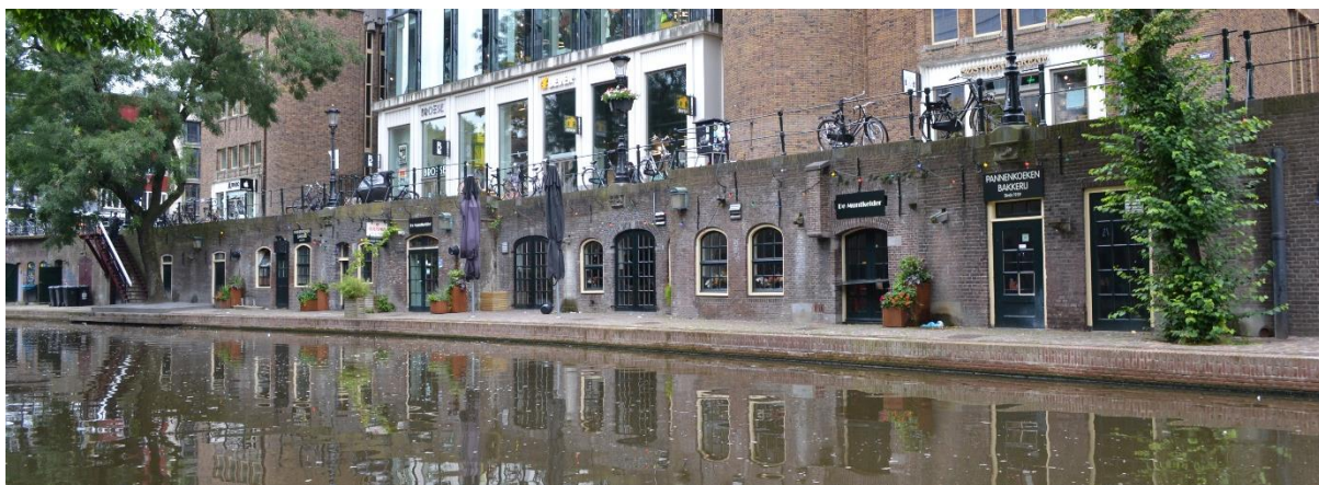
Figuur 22: bestaande toestand aangezicht werfmuur nummers 112A t/m 112-L8
