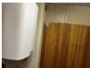
Foto boiler in bergruimte.
