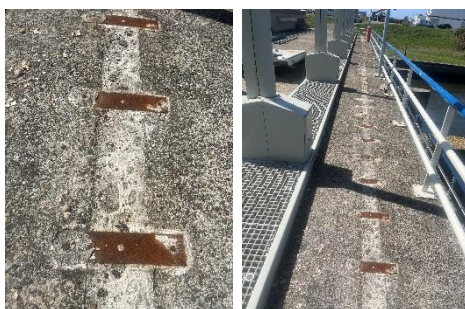
Foto's restanten ankerplaten uitstroomzijde.
