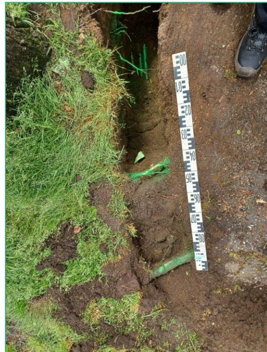
Foto 10 Aangetroffen beworteling en kabels
