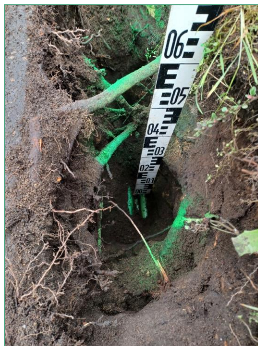
Foto 4 Aangetroffen beworteling en kabels
