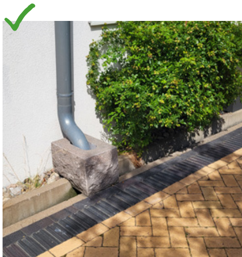
▲ Wel : open water afvoer van dak.
