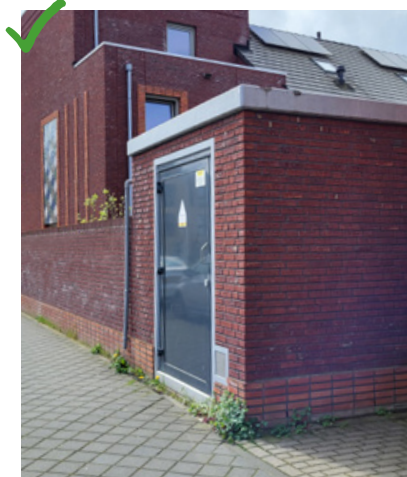
▲ Wel: trafo's geïntegreerd in de architectuur.
