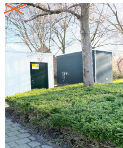
▲ Niet: losse trafo's in de openbare ruimte.
