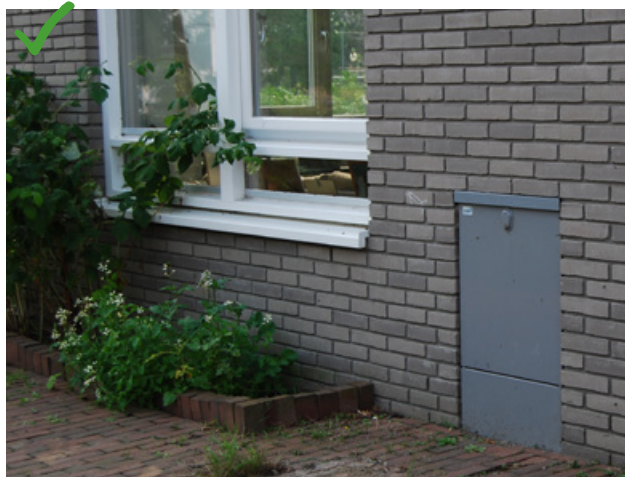
▲ Wel: cai-kasten geïntegreerd in gebouw
