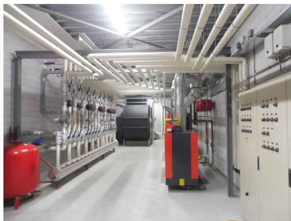
Inkijk in de technische ruimte op de verdieping.
