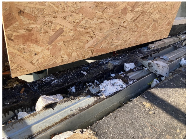
Foto 3: detail opname schadelocatie
