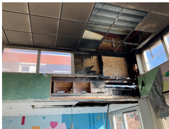
Foto 5: Detail hoek waar de brand is ontstaan
