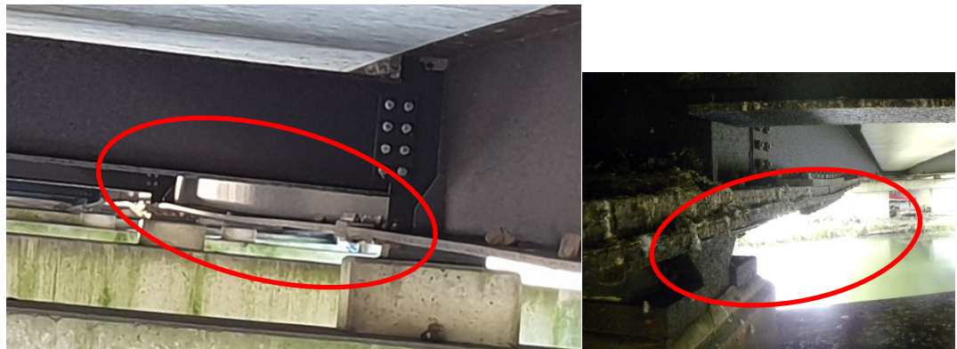
Figuur 12 Knik in de onderflens van de hoofdliggers veroorzaakt (waarschijnlijk) door het aanbrengen van de zeeg tijdens het bouw
