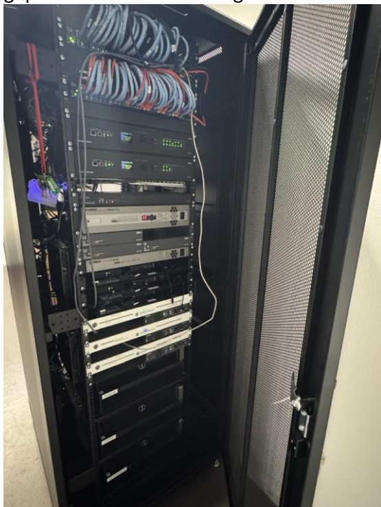
Main Av –Rack
