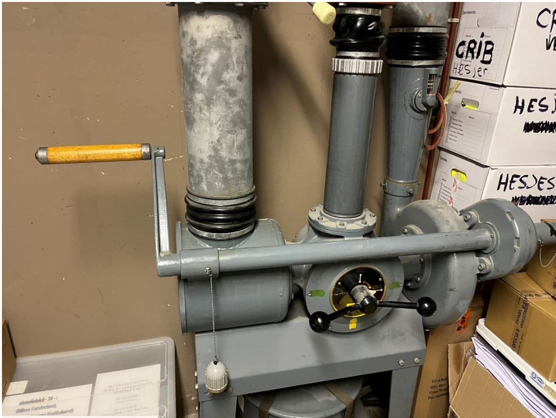
luchtbehandelingsinstallatie met mogelijkheid voor handbediening en schakeling tussen ongefilterd en gefilterde buitenlucht.
