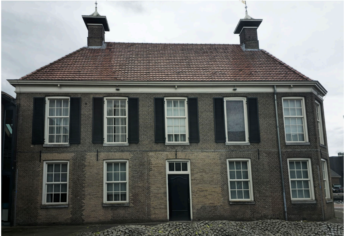
Figuur 34. Overzicht van de achtergevel van het historische raadhuis van Nijkerk. Op de begane grond zijn de bouwsporen te zien van de laatste grote verbouwing uit 1979 waarbij veel gevelopeningen uit 1939 zijn dichtgezet en nieuwe zijn aangebracht. Tussen de begane grond en de verdieping bevindt zich een loodslab.
