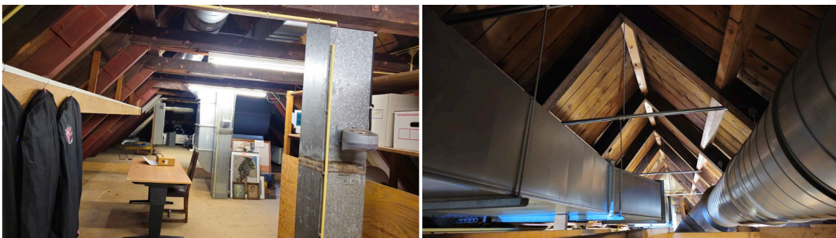
Figuur 42. Kapconstructie van het achterhuis met links verschillende spanten achter elkaar met naoorlogse stalen ondersteuning. Rechts een overzicht van boven in de kap. De gordingen zijn vermoedelijk secundair aangebracht.
