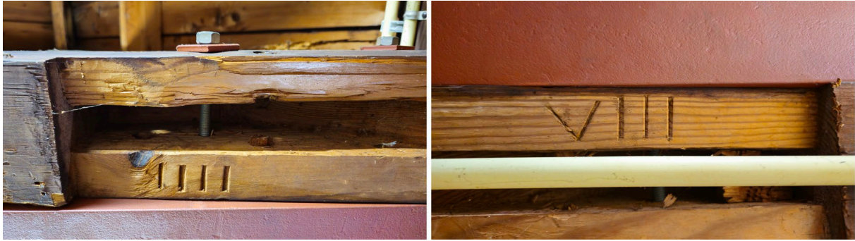
Figuur 44. Twee voorbeelden van de gehakte telmerken in de kapconstructie van het achterhuis.
