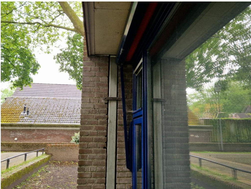
Figuur 10. Bij de bouw zijn ingebouwde regenpijpen toegepast. Rondom deze buizen zijn kieren aanwezig die door vleermuizen als toegang worden gebruikt.
