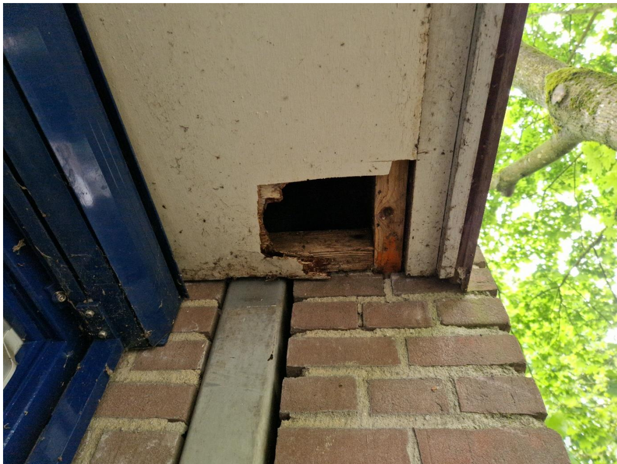
Figuur 6. Gat onder een dakrand die als toegang gebruikt kan worden door steenmarter.
