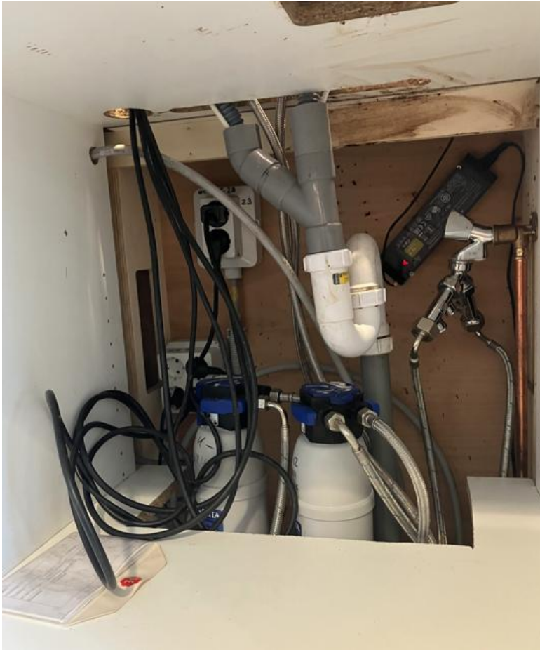
Afbeelding : water en elektra aansluiting pantry's locatie Delft
