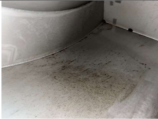
Dirty Inlet Plenum
