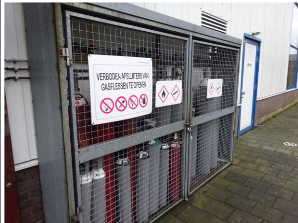
Gasflessenberging buiten het gebouw
