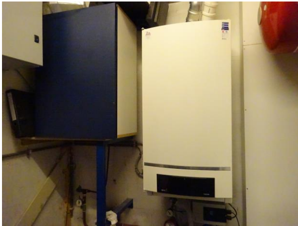
De cv installatie op het kantoor
