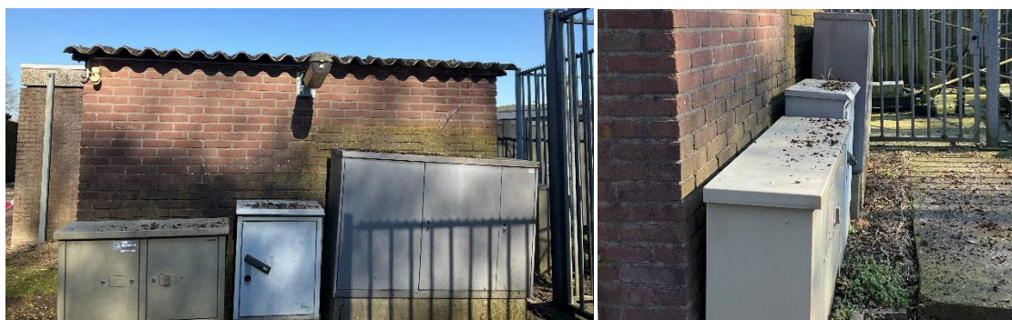
Afbeelding 2.6: Foto's van asbestverdachte dakbedekking (links) en inspoelzone (rechts)
