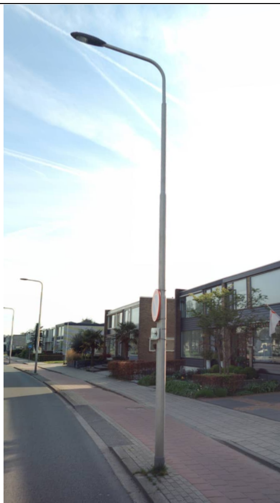
Foto nieuwe situatie, brandend armatuur op externe voeding
