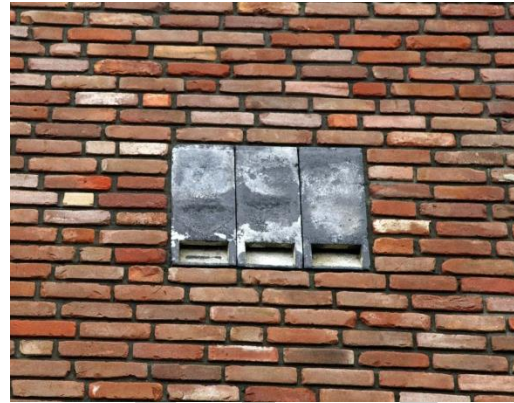
Drie vleermuiskasten naast elkaar ingemetseld
