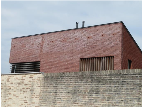
Een cluster van tien ingebouwde gierzwaluw-nestkasten, die tot op heden door gierzwaluwen nog steeds worden gebruikt. St. Sebastiaanstraat, Hilvarenbeek
