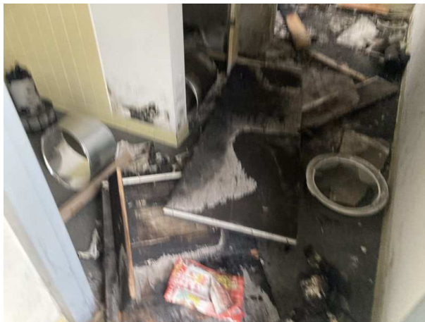
Beschadigde gedeelte van het herentoilet
