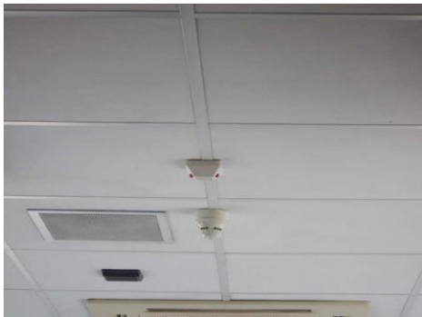
Brandmeld- en ontruimingsinstallatie (BMI), -, -
