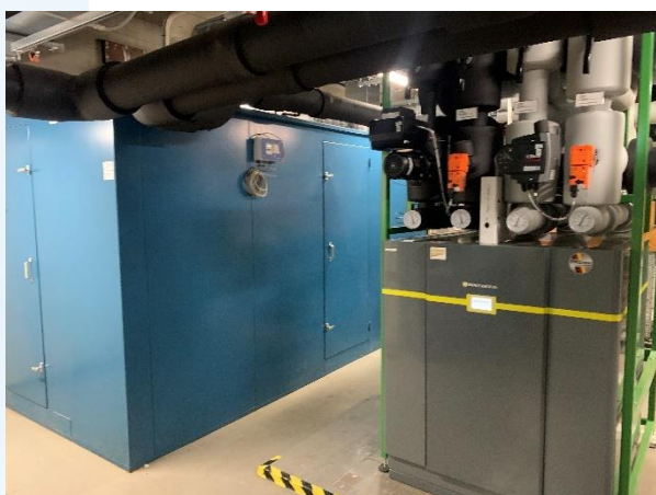
Noodstroomaggregaat opgesteld in de kelder.
