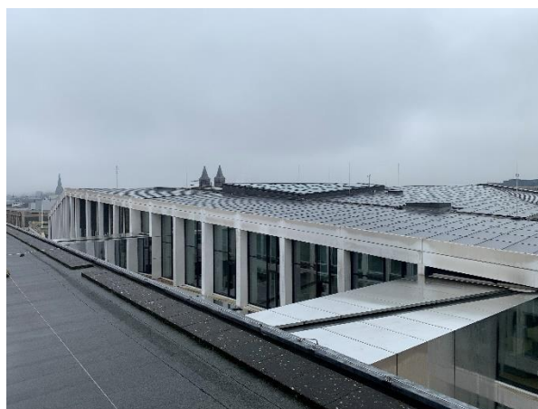
PV-installatie op het dak van gebouw 2.
