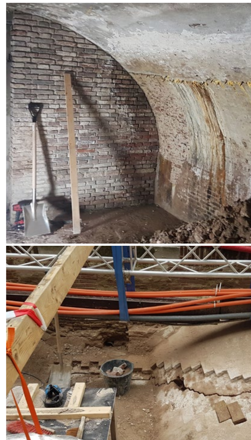
Boven: Een kelder met sporen van lekkages en vochtinwerking Onder: Herstel van grote scheuren aan de bovenkant van een keldergewelf (Foto's: gemeente Utrecht)
