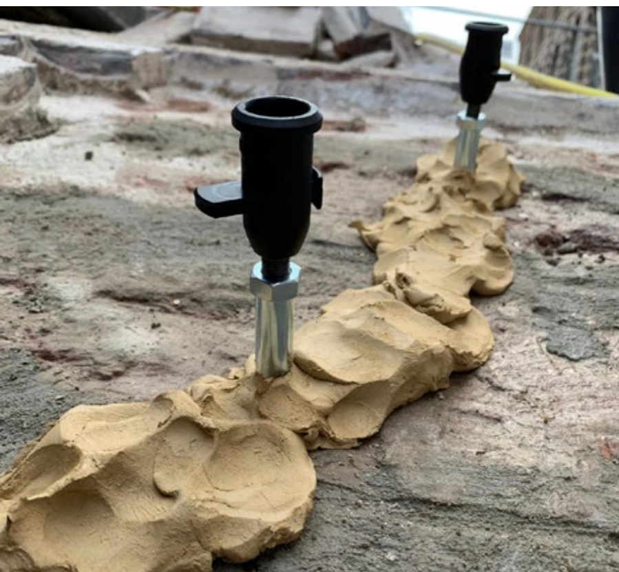
Boven: het aanbrengen van een waterdichte laag op een kelderboog Onder: het herstellen van scheuren in het metselwerk van de kelderboog (foto's: Gemeente Utrecht)
