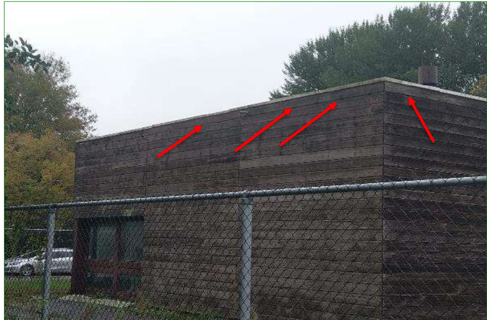
De vleermuizen bij het gevonden kraamverblijf vlogen op verschillende plaatsen in via de ventilatiegaten in de gevelbekleding (zie rode pijlen).
