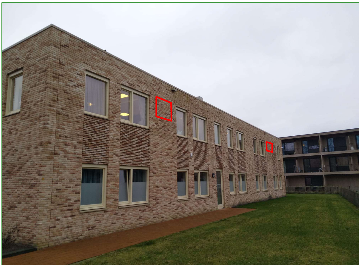
Twee geverfde kasten aan de bebouwing van 'De Rotonde'. Bovenkant kast gelijk met bovenkant kozijnen, in voegen
