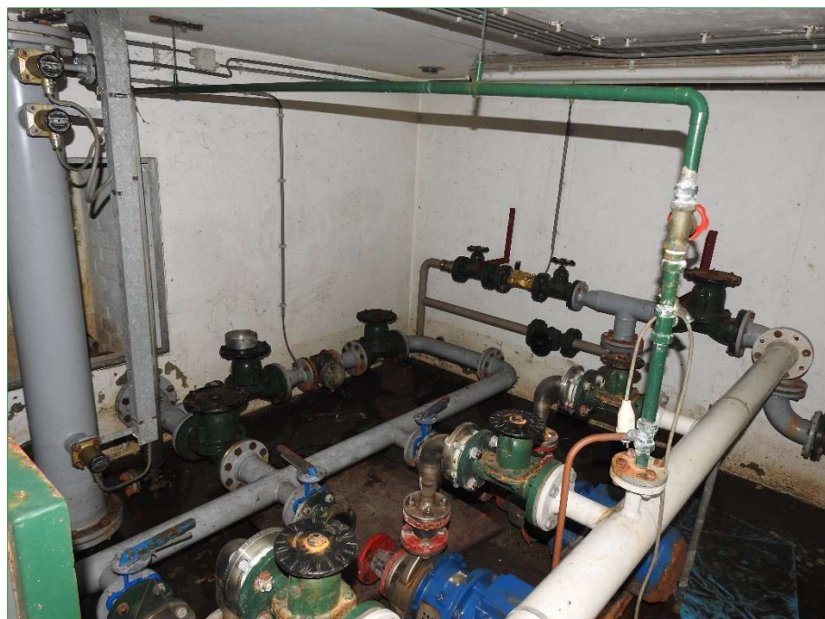
Binnenzijde van het pomphuis met de leidingen die op termijn verwijderd zullen worden.
