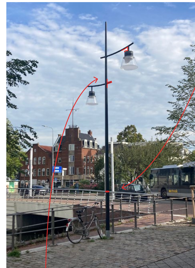
Verbinding van losse onderdelen; de lampen lijken te hangen en zitten niet direct aan de paal, maar via naar buiten uit stekende hangers verbonden
