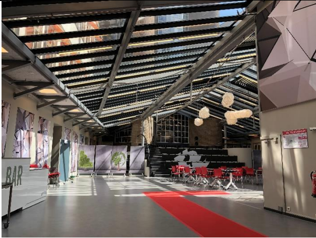
Inkijk laagbouw atrium voorzien van sprinklers
