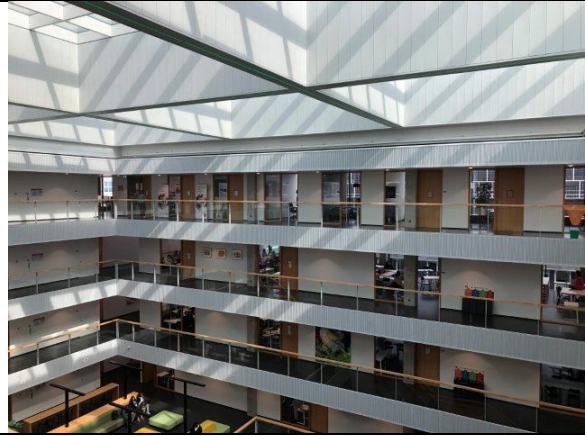
Atrium in gebouwdeel D, voorzien van een RWA-installatie.
