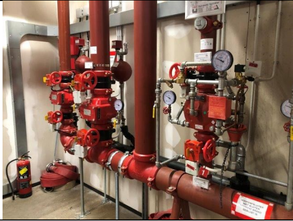
Impressie van de sprinkler pomp ruimte.
