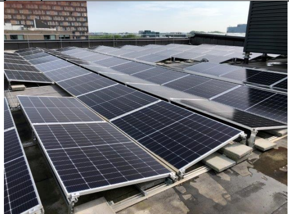
Zonnepanelen op gebouwdeel C.
