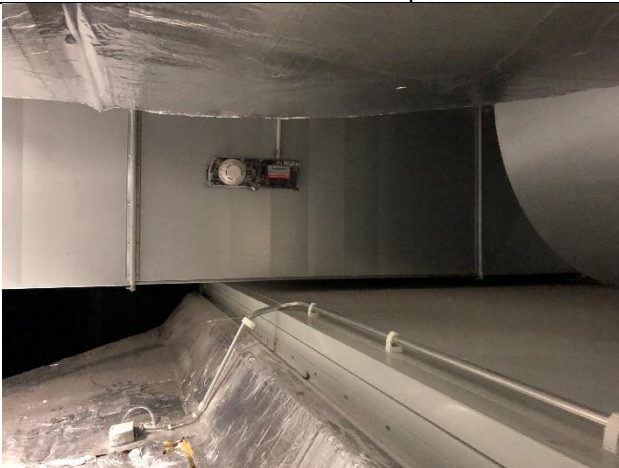
Hvac installatie voorzien van automatische rookmelder.
