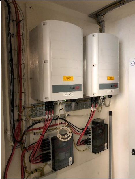
De twee omvormers van de zonnepanelen
