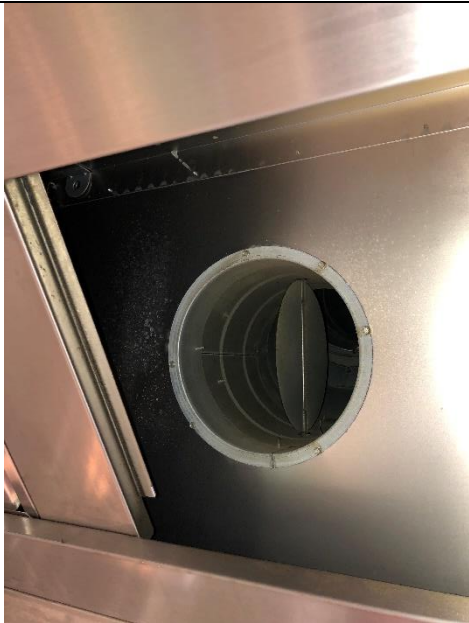
Schoon afzuigkanaal keuken
