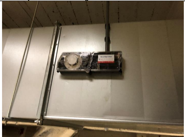
Hvac installatie voorzien van automatische rookmelder.
