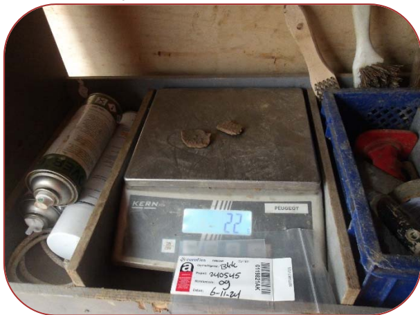
Foto 35: Asbestverdacht materiaal in funderingslaag boring 09
