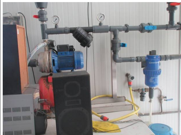
Hydrofoor t.b.v. beregeningsinstallatie (in de kas)
