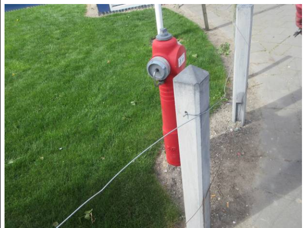
Hydrant op eigen terrein
