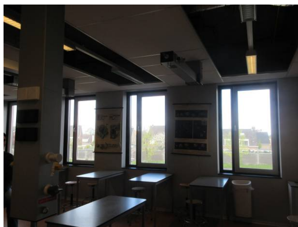
Scheikundelokaal met afnamezuilen (gas, water en elektriciteit)
